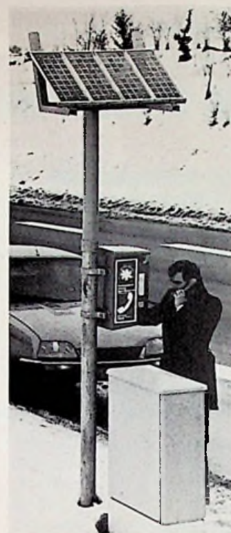
Ein beleuchtetes Notruf-telefon mit einer Stromversorgung über Solargeneratoren wurde auf der Bundesstraße B14 im Schwarzwald in Betrieb genommen. Die 0,5 m 2 großen Generatoren liefern eine Leistung von maximal 40 W. (Bild: AEG-Telefunken)
